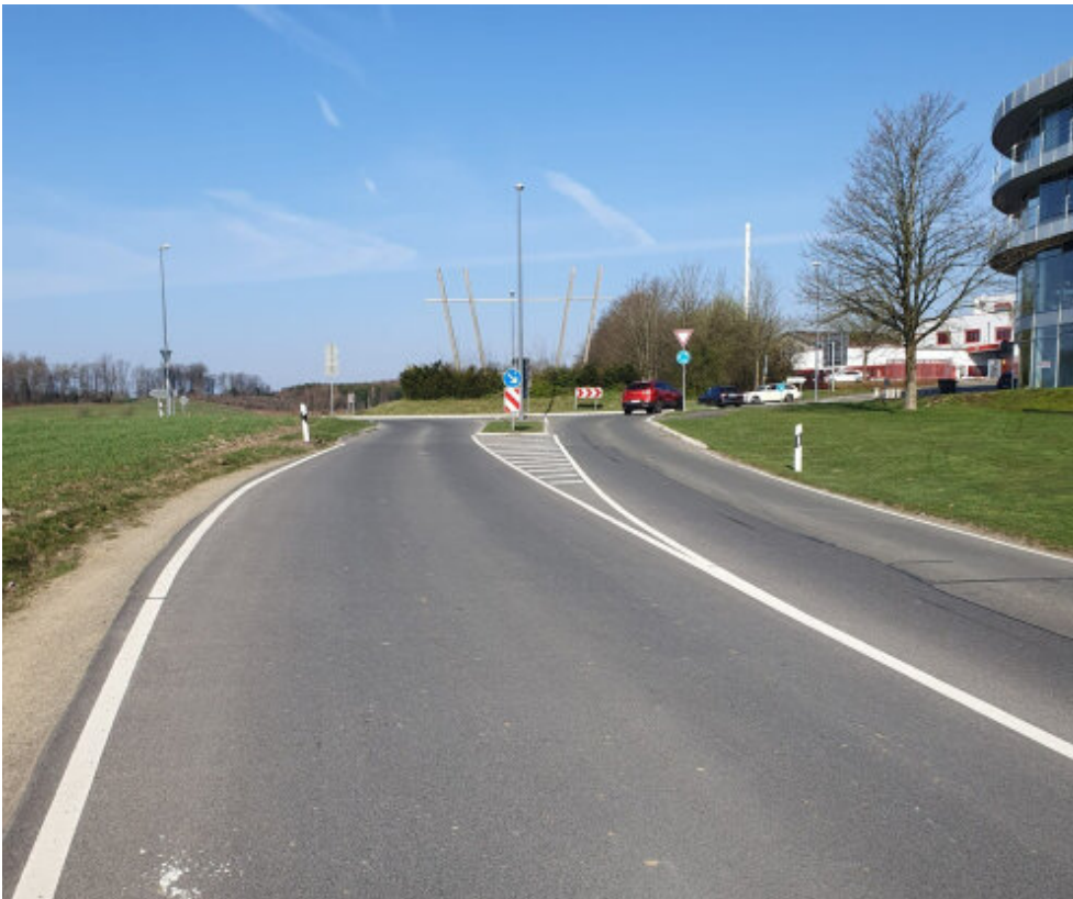
Die K 19 wird im Bereich der Zufahrt zum Kreisverkehr Lindlar Klause saniert. (Foto: OBK) Link auf Original-Bild
